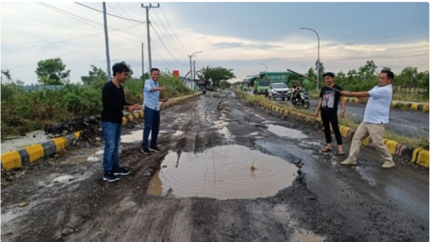
Telan Anggaran Rp13 M, Aspal Jalan Lingkar Kabupaten Jeneponto Rusak Parah.
